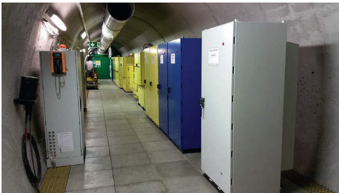
Bild 13 Ausrüstung eines Querschlags am GBT (Bild T. Jesel, Ingenieurgesellschaft GBT Süd)
